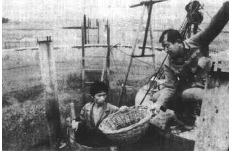
△担负东城供水的油田供水公司辛安水源管理站为了保证市民饮用水水质清洁，组织职工自己动手对工组澄清池的配水系统进行了清洗抢修。职工们下到6米多深漆黑闷热的布水廊道里，弯着腰用人工一点一点地将96根配水管里的淤积物全部清除干净。既提高了水处理效果。又为单位节约维修费1万余元。图为职工正在清淤作业。(翟佃波 摄)
